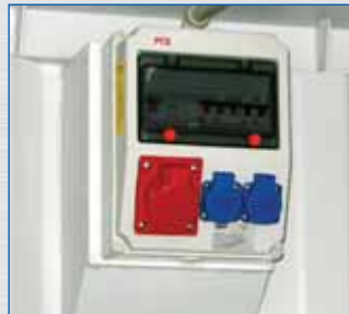
Verteilerkasten mit integrierten Steckdosen
